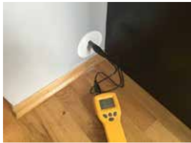
Hulltaking fra entre/gang. Relativ luftfuktighet 20%.
