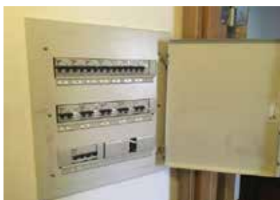
Sikringskap på vaskerom.
