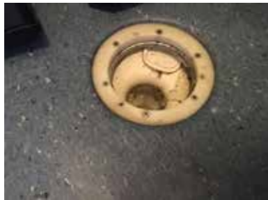
Sluk i plastkonstruksjon. Slukkopp kunne ikke løftes ut/fjernes.
