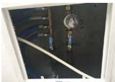
Stoppekran for kaldtvann og varmtvann i himling på bad 1.
