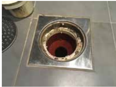
Sluk i plastkonstruksjon fra byggeår.
